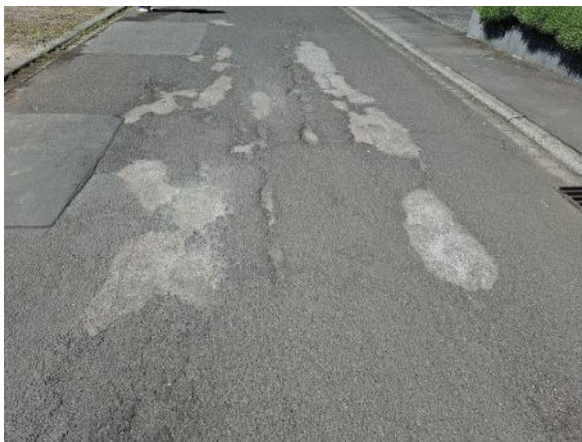
Abbildung 347: Straßenschäden in der Clausenburgstraße
