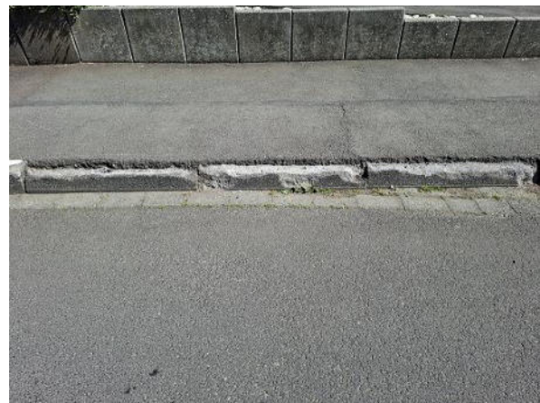
Abbildung 338: Schäden an den Bordsteinen vor der Sporthalle
