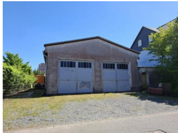
Abbildung 131: Verschönerungs- / Sanierungsbedarf an Nebengebäude in der Elisabethstraße
