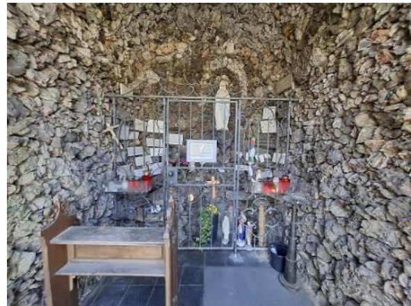
Abbildung 295: Inkrustationsflächen im Innenraum der Lourdes-Kapelle
