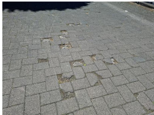
Abbildung 348: Straßenschäden in der Elisabethstraße
