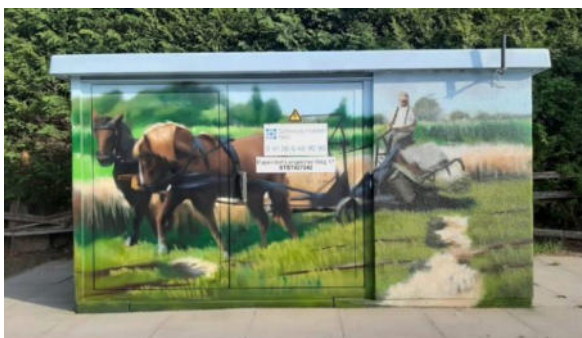
Abbildung 206: Beispiel einer professionell besprühten Transformatorstation Quelle: https://die-sprueherei.de/wp-content/uploads/2020/09/552e26ac-4214-4ad8-b592-a49fa99d393d-1024x590.jpg
