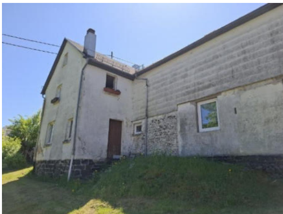
Abbildung 128: Verschönerungs- / Sanierungsbedarf an Wohngebäude in der Weitfelder Straße (nicht Teil der L 286)
