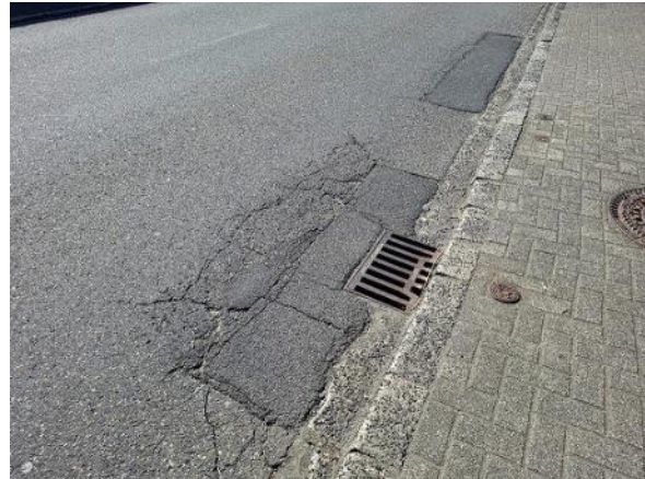
Abbildung 346: Straßenschäden in der Marienberger Straße / L 287
