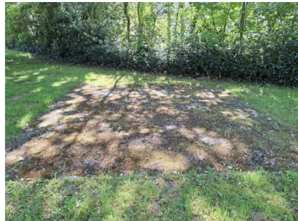
Abbildung 269: Vermooste Pflasterfläche II
