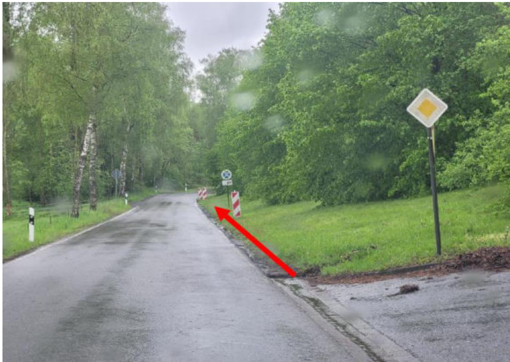
Abbildung 56: Einmündung im Bereich Hauptstraße 1, Treibgut und ausgespültes Bankett
