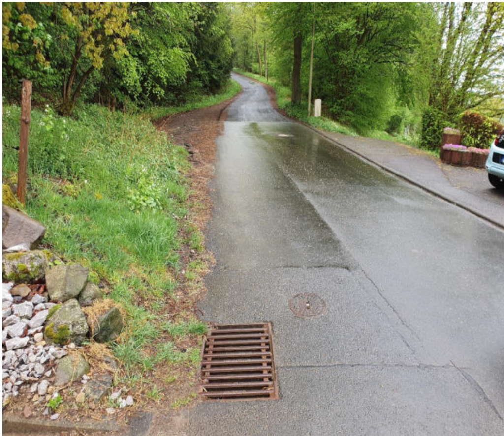
Abbildung 14: Kausen: Sportplatzweg, Blick Richtung Sportplatz, Einlauf gegenüber Bebauung; Gefahrenpunkt 9.4
