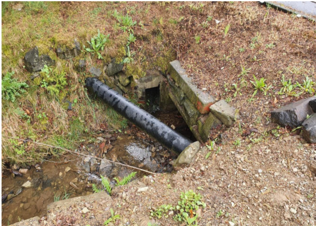
Abbildung 11: Kausen: Einlauf in Verrohrung des Flutgrabens im Bereich Austraße; Gefahrenpunkt 9.10
