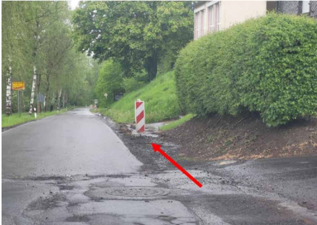
Abbildung 58: Bereich Einmündung Kirchstraße/Hauptstraße, ausgespültes Bankett
