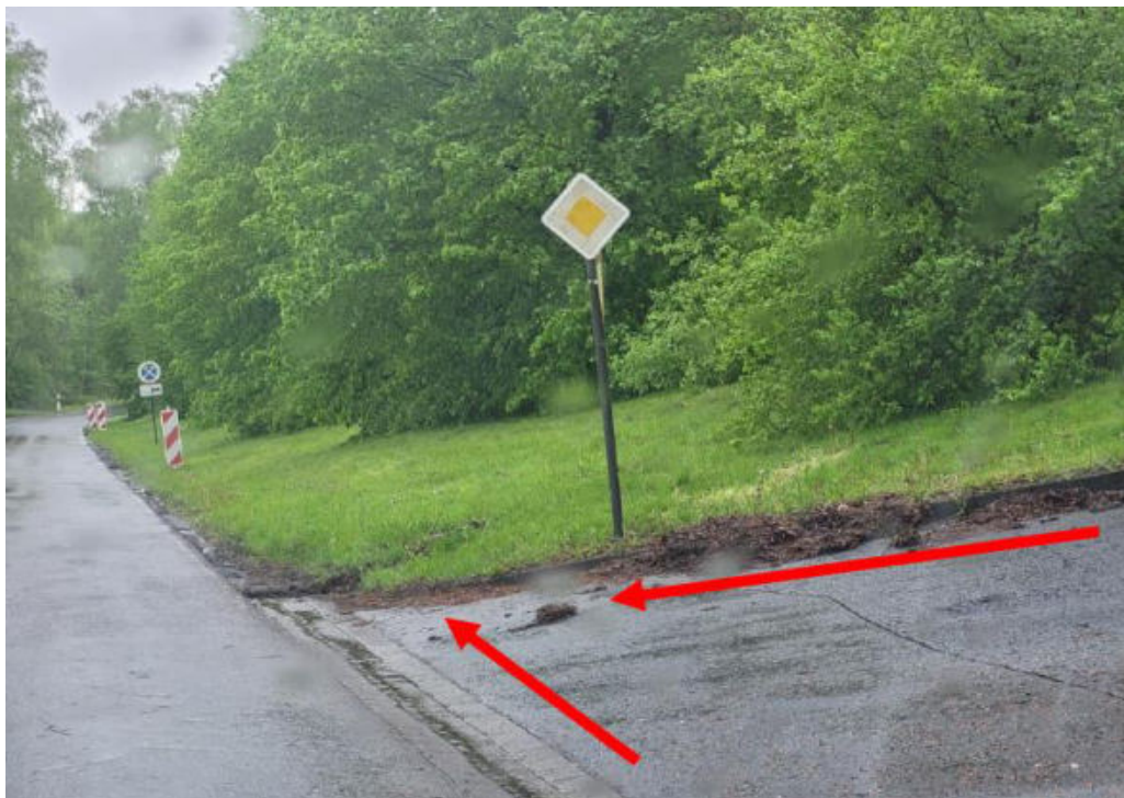
Abbildung 57: Einmündung im Bereich Hauptstraße 1, Treibgut und ausgespültes Bankett
