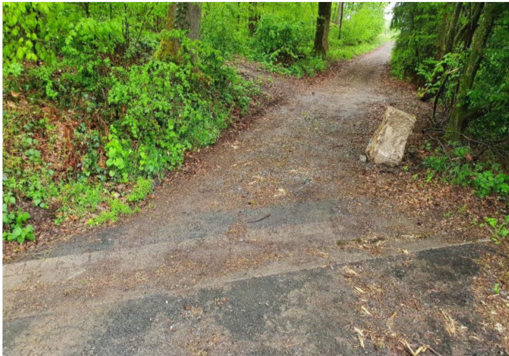
Abbildung 47: Einmündender Weg mit Querrinne im Bereich Durchlass K118; Gefahrenpunkt 9.8
