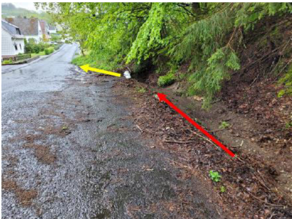
Abbildung 62: Verstopfter Durchlass und Wegeseitengraben in Verlängerung des Sportplatzweges Gefahrenpunkt 9.17
