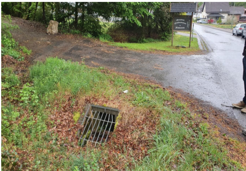
Abbildung 46: Einlauf Straßenseitengraben/Durchlass K118 Richtung Bach, östlicher Ortseingang/Blick Richtung Ort; Gefahrenpunkt 9.8
