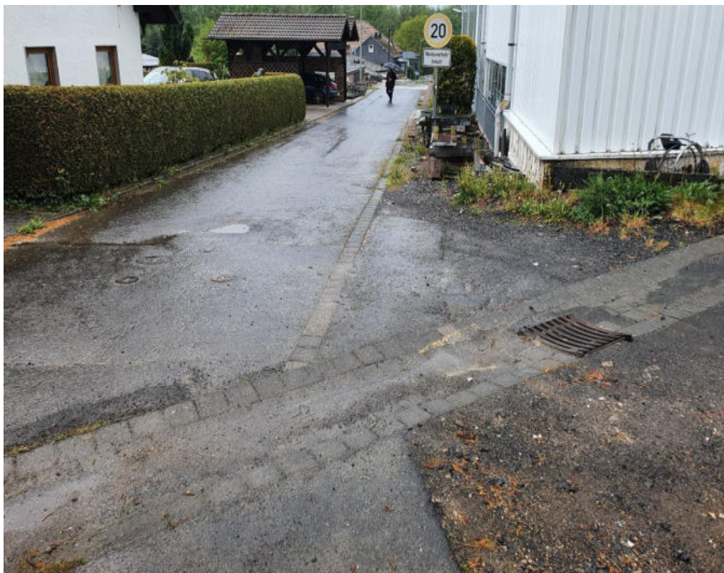
Abbildung 25: Kausen: Käuserstruth, Blick Richtung L287; Gefahrenpunkt 9.7
