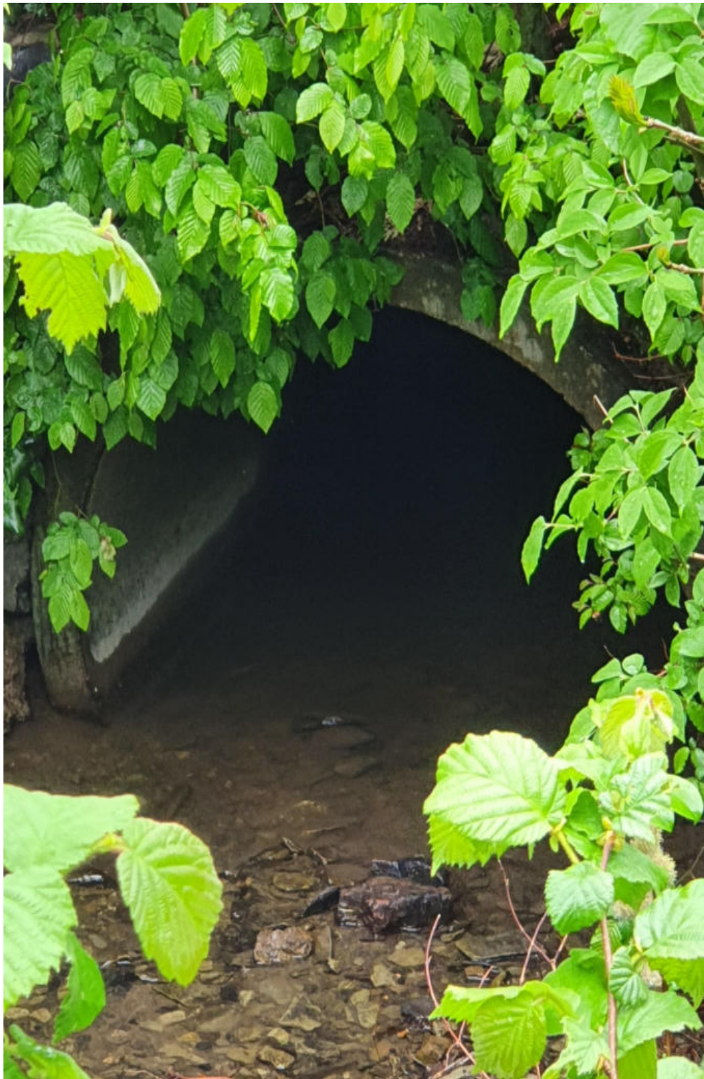
Abbildung 10: Kausen: Einlauf in Verrohrung des Flutgrabens im Bereich Austraße; Gefahrenpunkt 9.10
