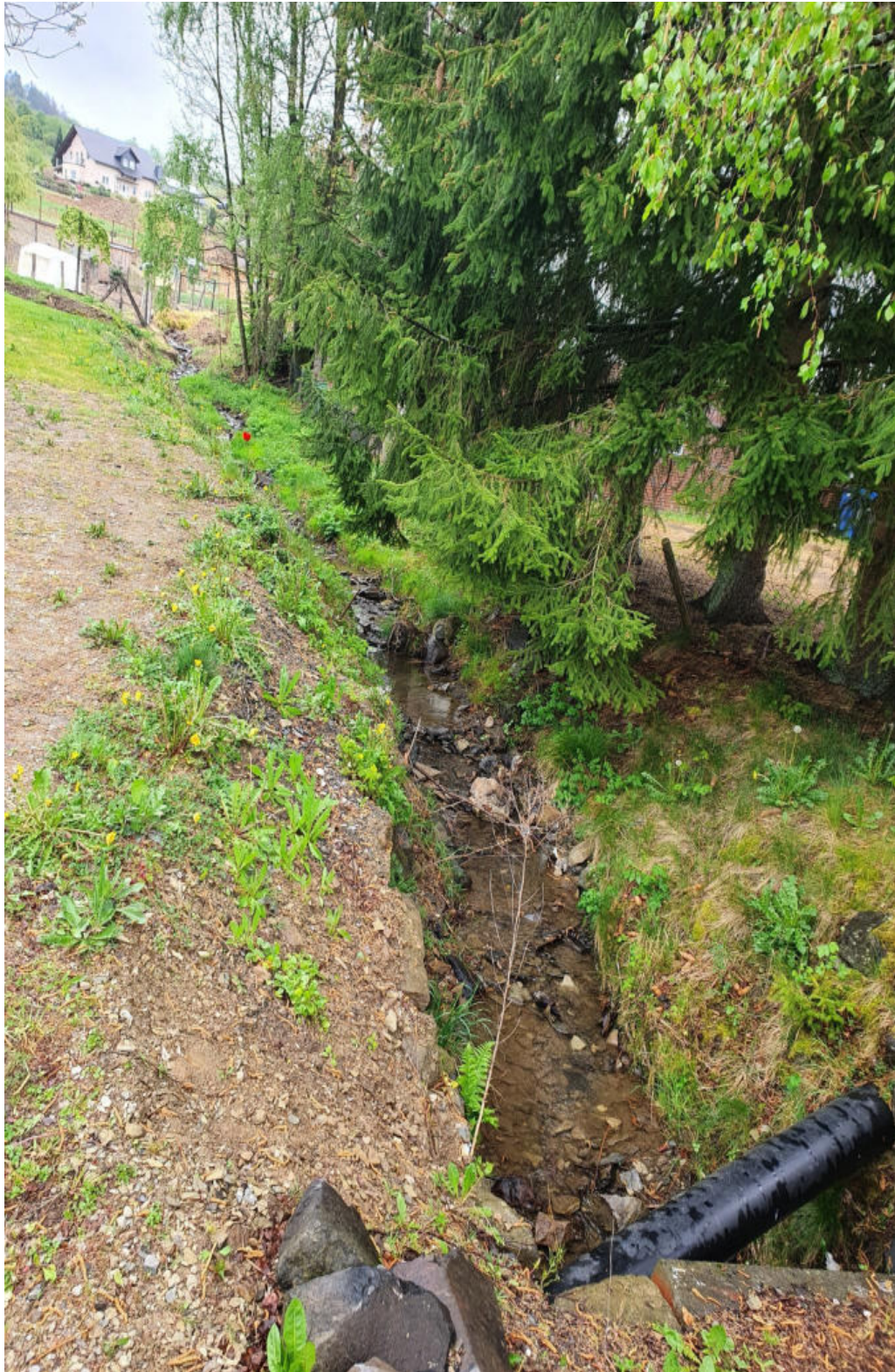
Abbildung 9: Kausen: Flutgraben im Bereich Austraße; Gefahrenpunkt 9.10
