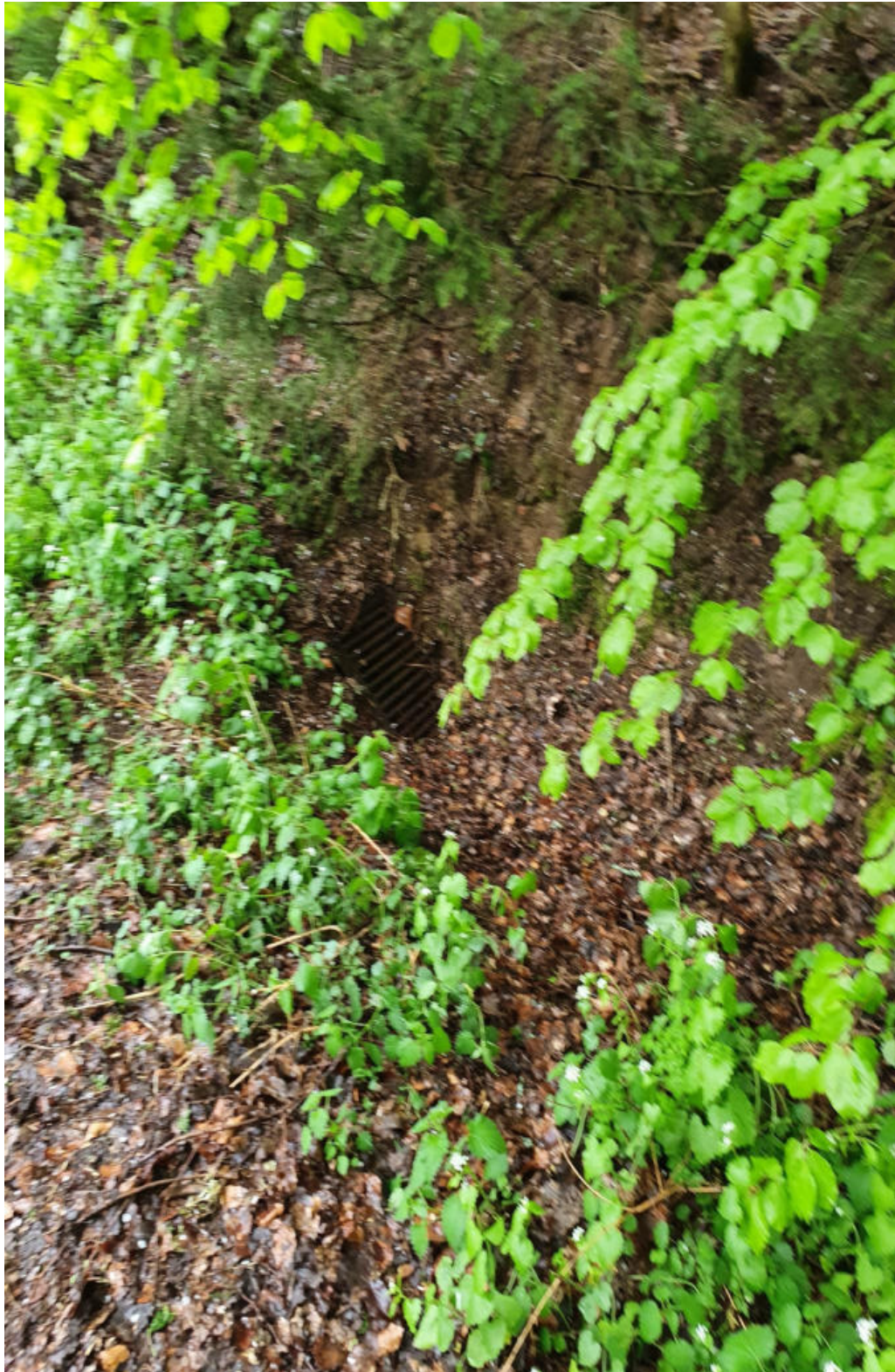
Abbildung 17: Kausen: Sportplatzweg, Einlauf in Verrohrung; Gefahrenpunkt 9.4
