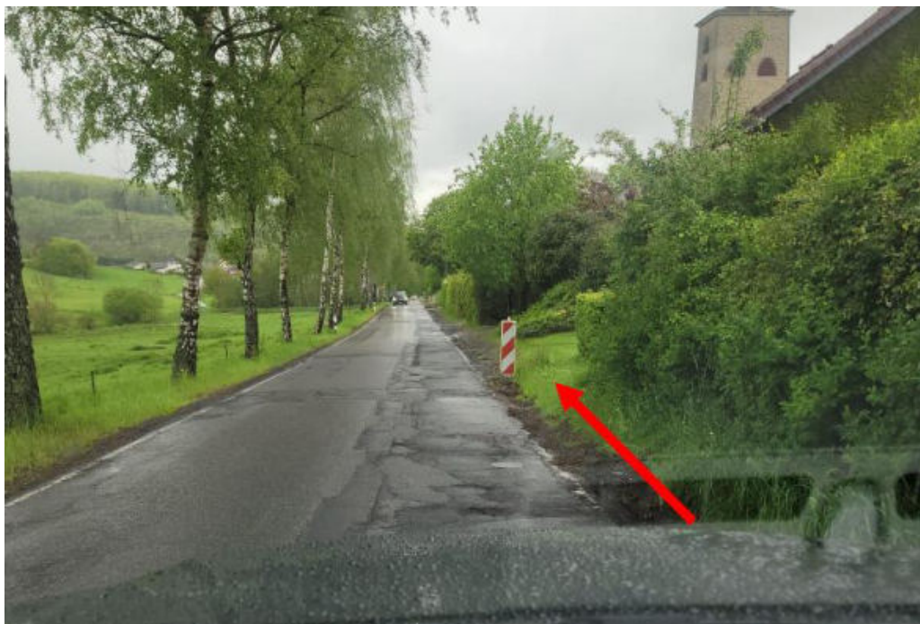
Abbildung 59: Bereich Hauptstraße 5; ausgespültes Bankett
