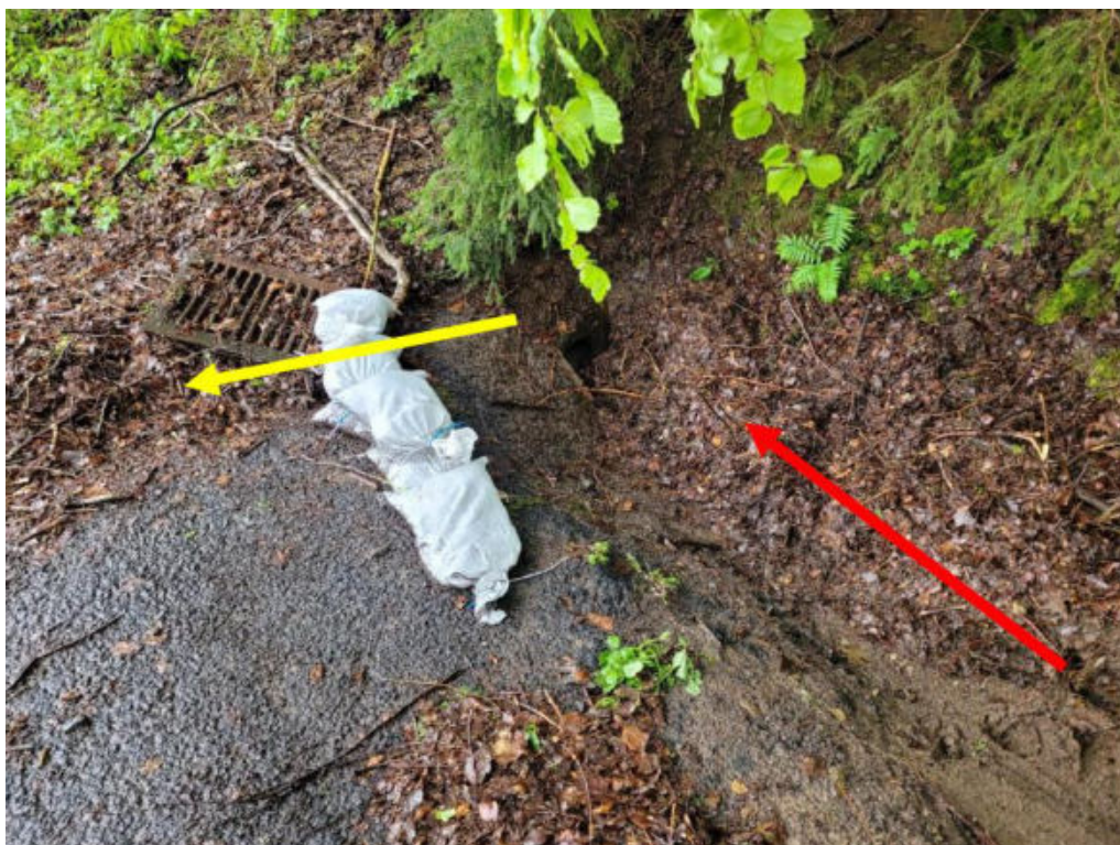
Abbildung 63: Verstopfter Durchlass und Wegeseitengraben in Verlängerung des Sportplatzweges Gefahrenpunkt 9.17
